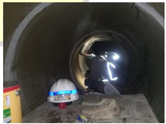
Dokumentasi Pemeriksaan Defect Pipa
