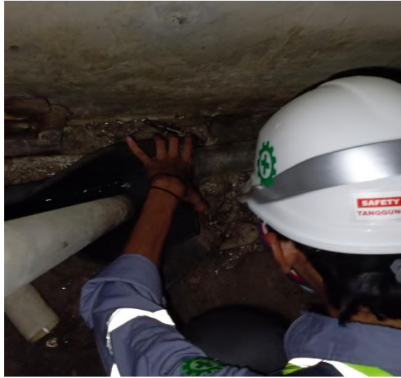
Gambar 4. 58 Rembessan Pada Terowongan (Sumber : Dokumentasi Pribadi, 2025)
