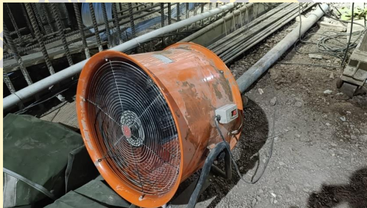
Gambar 4. 60 Kipas Moveable (Sumber : Dokumentasi Pribadi, 2025)
