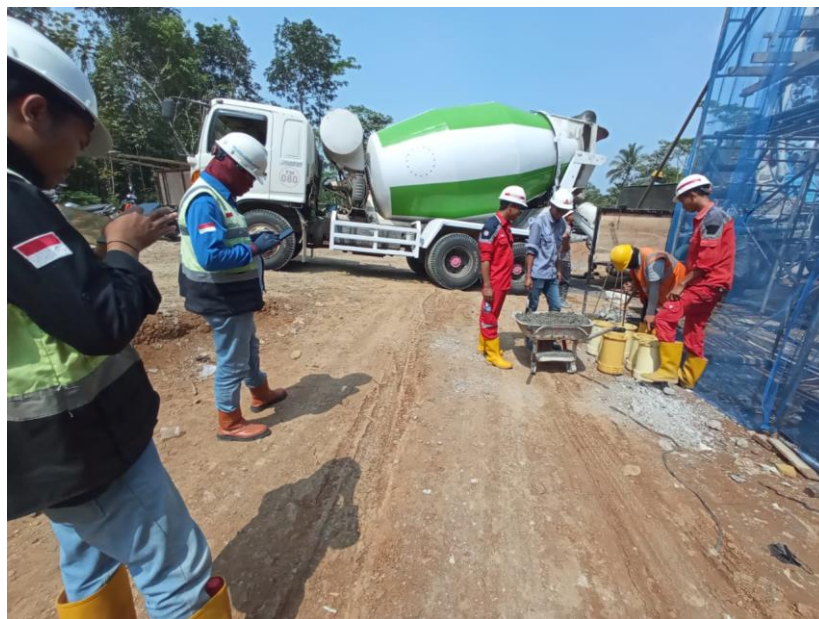
Gambar 3. 13 Truck molen yang digunakan dilokasi proyek
