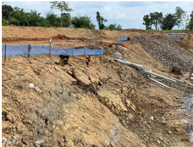
Gambar 1.1 Keruntuhan Tanah pada Lereng Kolam Regulasi (Sumber: Dokumentasi Pribadi, 2023)
