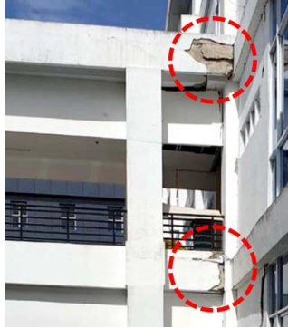
Gambar 8 Kerusakan Struktural pada Balok Dilatasi
