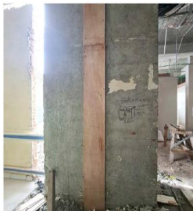
Gambar 18 Pemasangan Bekisting pada sepasang Kolom untuk Meratakan Permukaan Kolom yang telah dibobok dengan Cor Beton Grouting
