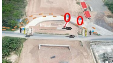
Gambar 8 Sketsa Tampak Samping (a) dan Tampak Atas (b) Situasi Awal Pelaksanaan Erection Girder Underpass .
