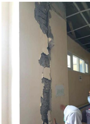
Gambar 7 Kerusakan Struktural pada Kolom Dilatasi
