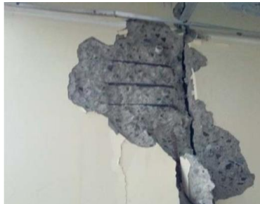
Gambar 6 Kerusakan Struktural pada Kolom Dilatasi
