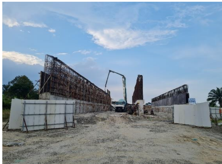
Gambar 1.2 Konstruksi Box Underpass Double Cell Proyek Jalan Tol Serbelawan - Pematang Siantar (Sumber: Dokumentasi Pribadi, 2022)
