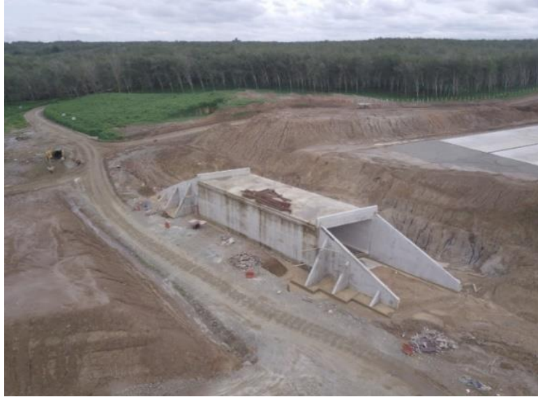
Gambar 1.1 Konstruksi Box Underpass Single Cell Proyek Jalan Tol Serbelawan - Pematang Siantar (Sumber: PT Hutama Karya, 2022)
